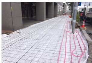
ロードヒーティング設備
