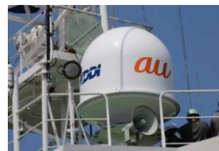
巡視船「さつま」のブリッジ上に設置された 実証試験用の携帯電話基地局
