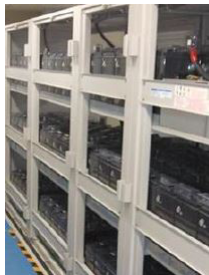
不要となった蓄電池
