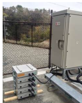
可搬型蓄電池
