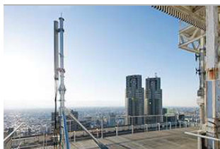
KDDI新宿ビル屋上に設置された 大ゾーン基地局アンテナのひとつ
