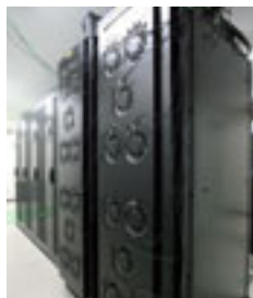
冷却ユニットを設置したサーバラック
