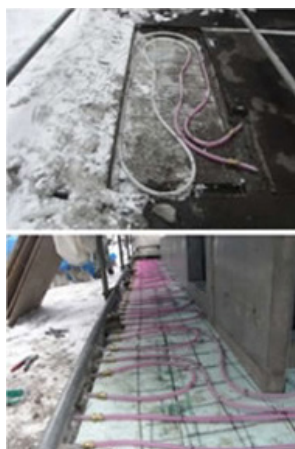
ロードヒーティング設備
