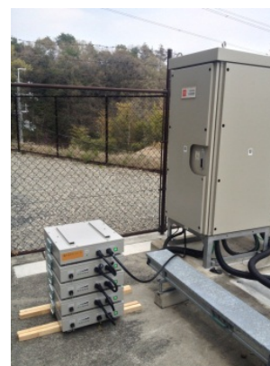
可搬型蓄電池
