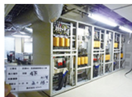
旧800MHz帯対応基地局の電源設備
