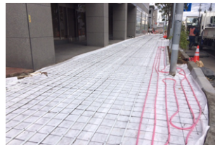
ロードヒーティング設備
