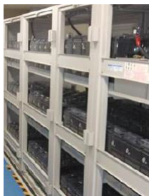
不要となった蓄電池
