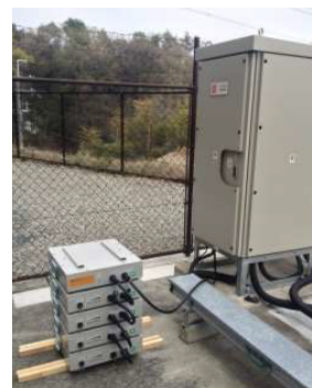
可搬型蓄電池
