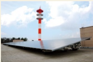
ソーラー発電システム (小山第二ネットワークセンター)
