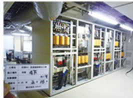
旧800MHz帯対応基地局の電源設備
