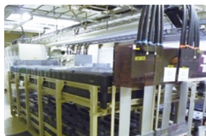
旧800MHz帯対応基地局のバッテリー (蓄電池)
